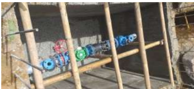
Estación de macromedición – regulación barrio la Unión
