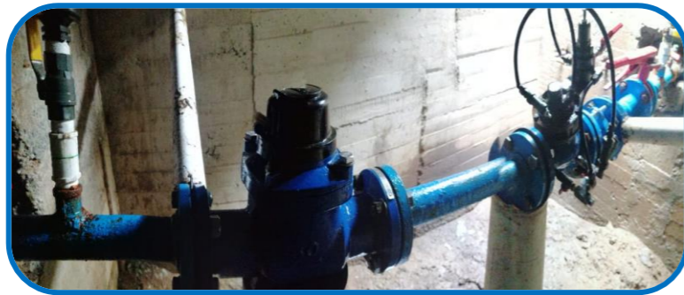
Optimización estación macromedidora rural vereda Guayabal
